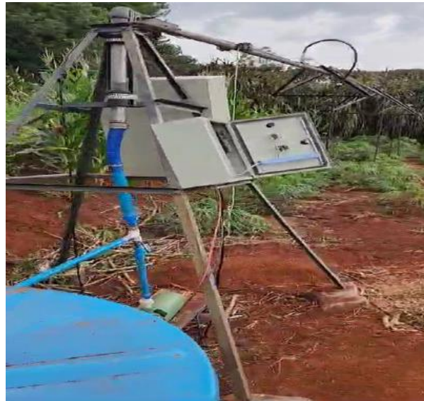
Figura 3 - Linha lateral do pivô central instalada.
