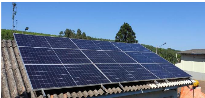
Figura 1 - Módulos fotovoltaicos instalados no telhado do LIF.
