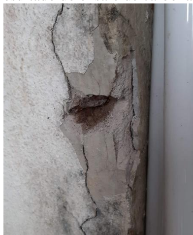
Figura 10: Resultado do ensaio de carbonatação no pilar.
