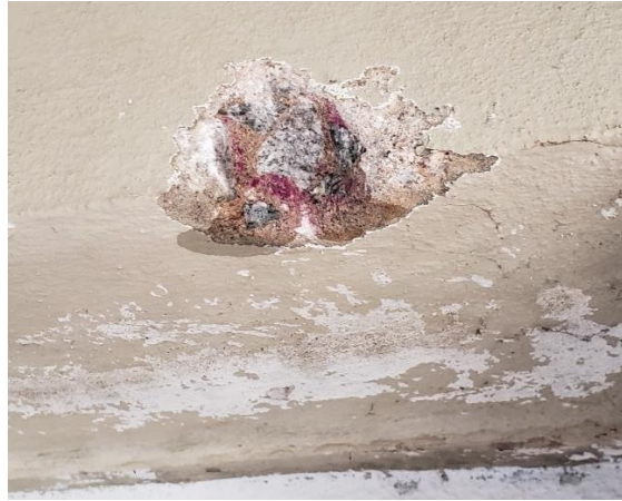
Figura 12: Parte não carbonatada da viga.
