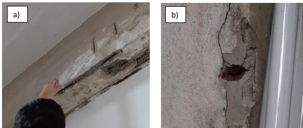
a) Aplicação da fenolftaleína na viga do hall do bloco 1; b) Aplicação da fenolftaleína no pilar do bloco 2 Fonte: Autores (2020).
