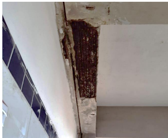
Figura 11: Viga do hall de circulação do bloco 1 com armadura exposta.
