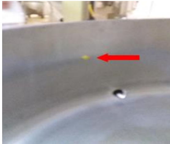
Figura 1 – Presença de material diferente do aço inoxidável AISI 304.
