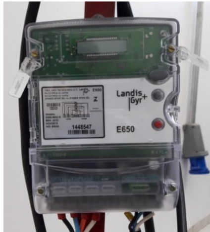
Figura 8 - Medidor de energia elétrica polifásico.
