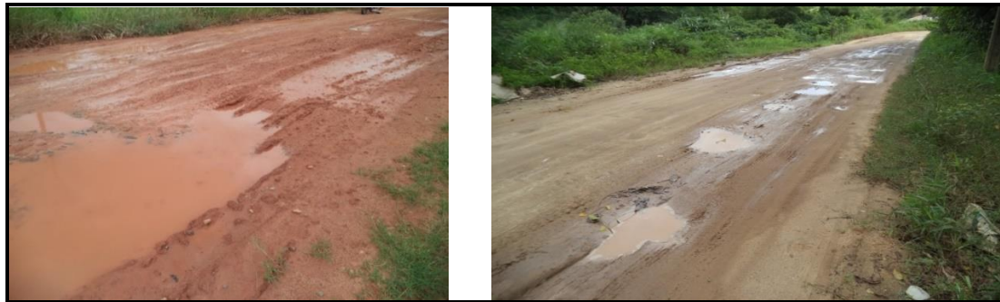
Figura 5 - Parte do Trecho PE-123, após fortes chuvas.
