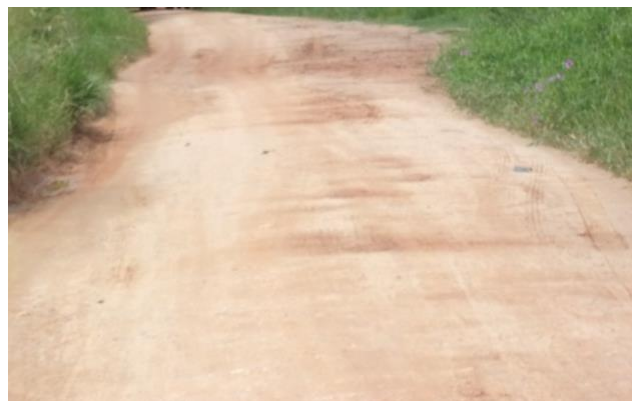
Figura 8 - Corrugações - patologia no trecho da PE-123.
