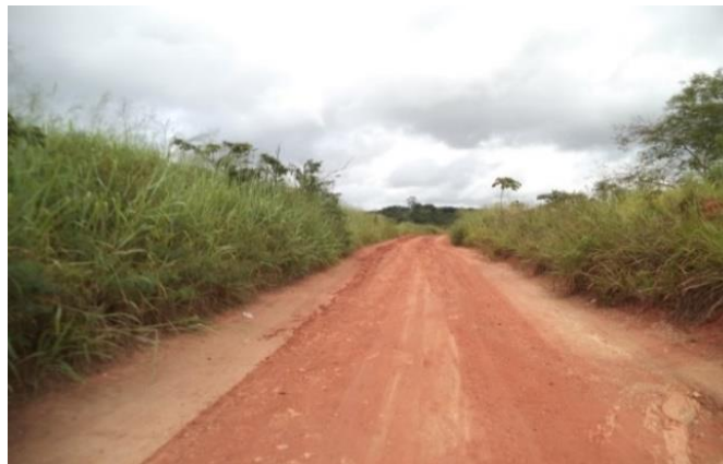
Figura 6 - Trilhas de Roda - patologia no trecho da PE-123.
