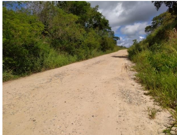
Figura 7 - Segregação de agregados - Patologia no trecho da PE-123.
