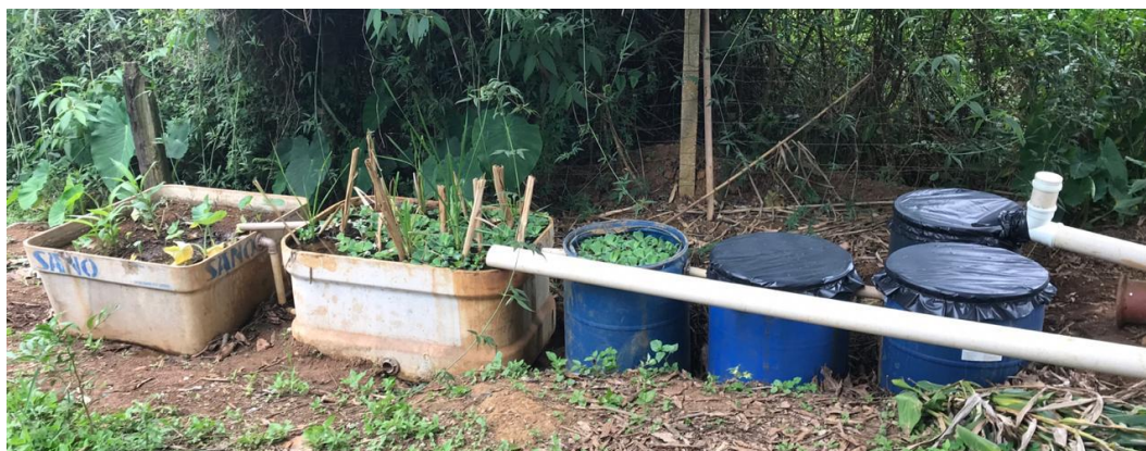
Figura 2 – Fossa biodigestora associada com alagados construídos
