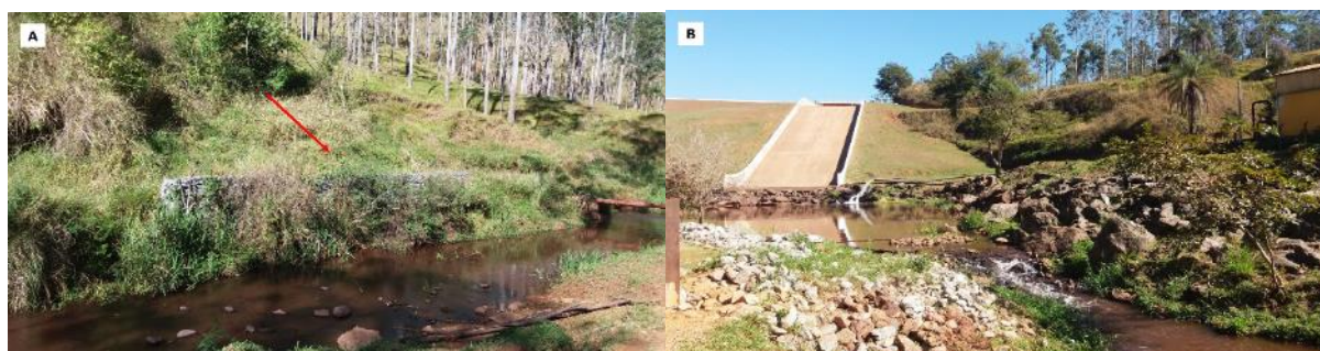
Figura 3 - (A) Gabião observado na margem esquerda do Rio do Peixe e (B) Visão geral da barragem de rejeitos do Rio do Peixe, município de Itabira (MG)
