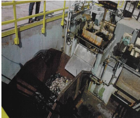
Figura 6. Caçamba onde são depositados rejeitos resultantes da limpeza das grades fixas;
