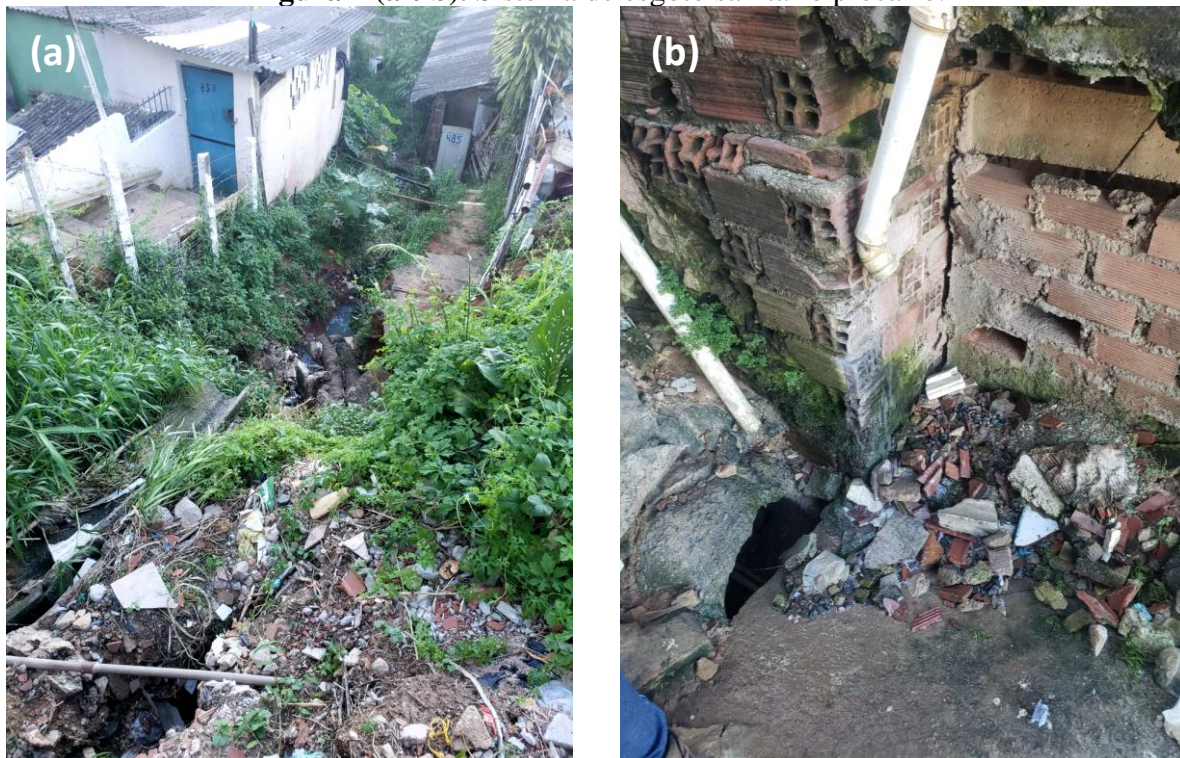
Figura 2 (a e b). Sistema de esgoto sanitário precário.
