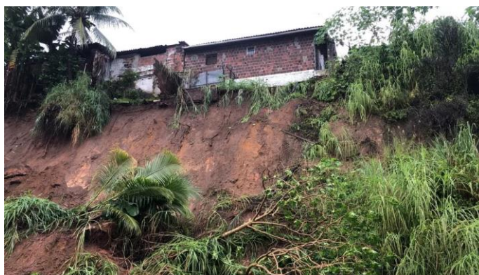
Figura 9 - Deslizamento no talude da BR 230 na comunidade Santa Clara em 2019.
