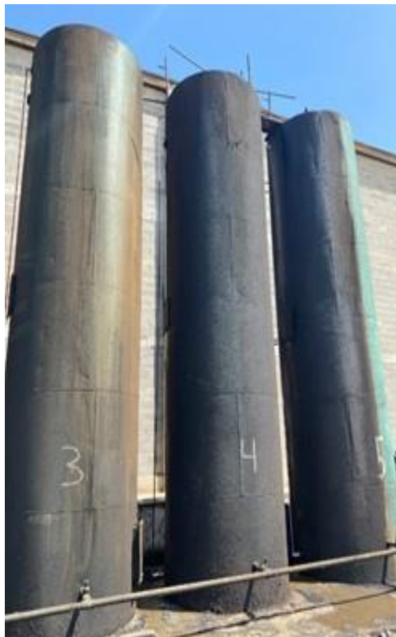
Figura 12 - Tanques de armazenamento do óleo de algodão pertencentes a Empresa Raça Forte da cidade de Patos-PB.
