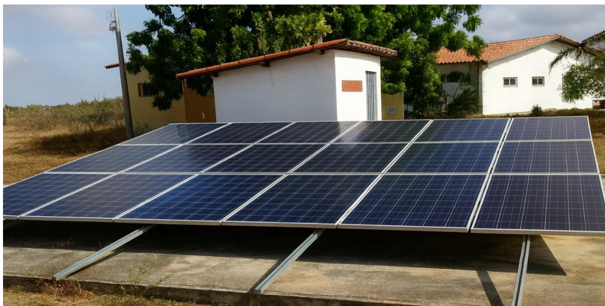
Figura 1 - Sistema Fotovoltaico Conectado à Rede.
