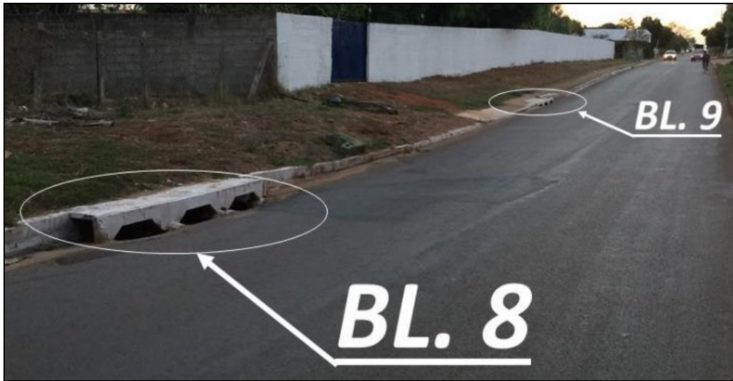
Figura 5 – Bocas de lobo 8 e 9 (tripla) – avenida Copacabana.
